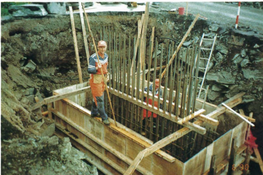
Sverre Hellen (på kanten) og Ommund Feed i arbeid med søylefundament på Bergje bru, tett ved tunnelen utanfor Vikevåg. Her skal byggjast toplanskryss med fylkesvegen.
