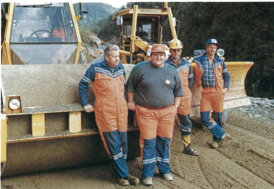
Siste "finpuss" før asfaltering på fylkesvegen mellom Øvrabø og Solland. Frå v.: Magnar Michelsen, Morten Sørås (korttidstilsett), Nils Krokedal og Svein Gjursland.
