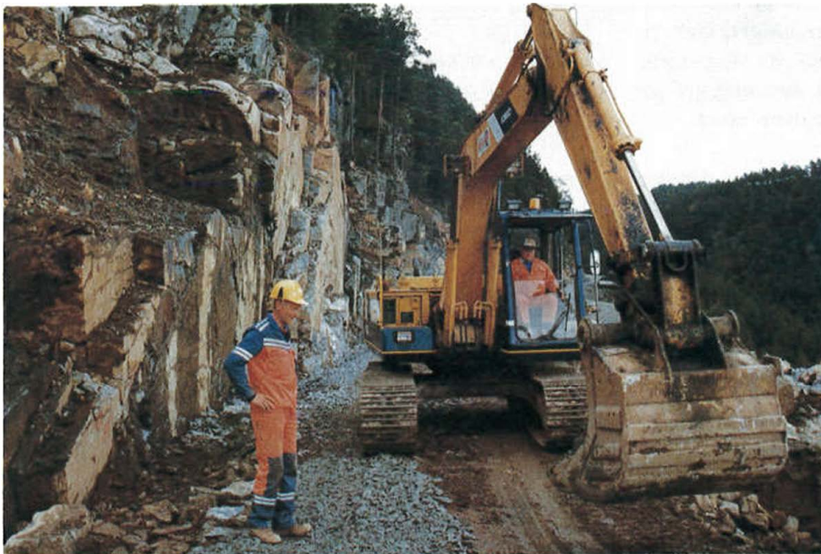
Entreprenør Ola Fisketjønn og vegvesenets Magne Tveit i arbeid med "innspurten" for å få vegen ned til Solland ferdig til 9. oktober.
