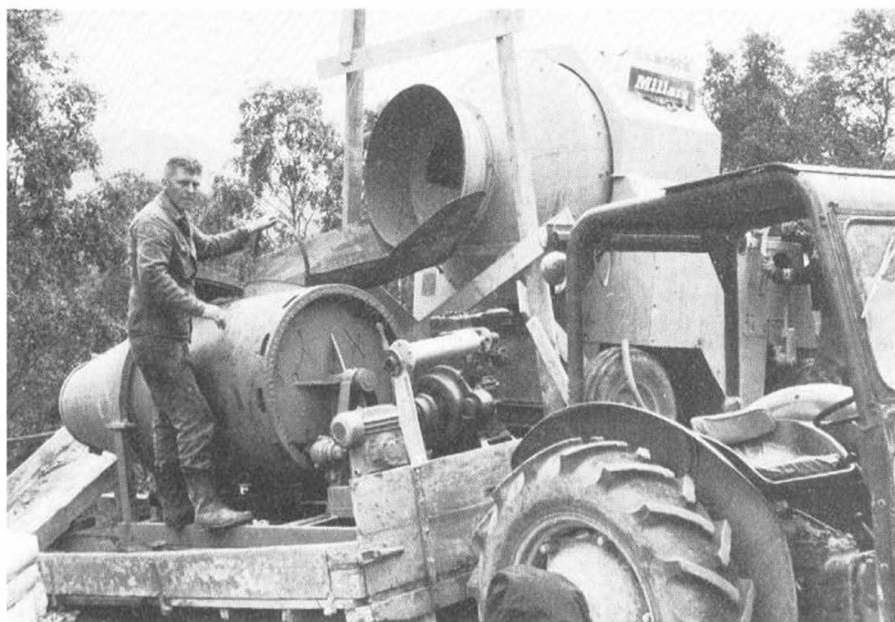
Blandemaskinen med renne, som fyller betongtrommelen. På tilhengeren står Sverre Veland, som hadde ansvar for blandemaskin og fylling av betongtrommelen. Han er bror til Bård Veland, og har sluttet i vegvesenet.
