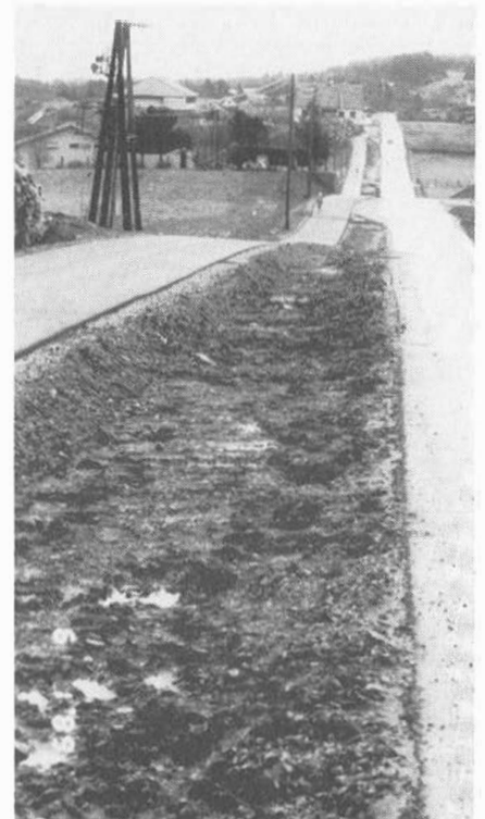
En del av den nye gang- og sykkelstien langs rv 51 på Karmøy. I bakgrunnen, midt på bildet, der vi ser Stokkastrand skole.
