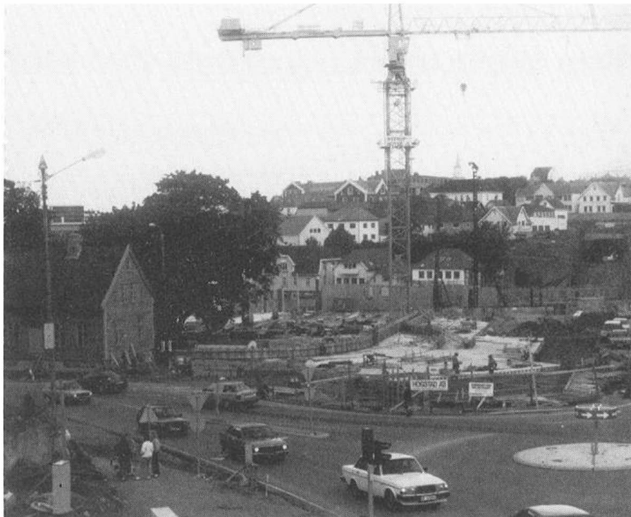
Oversiktsbilde for anleggsområdet fra Kannikkrysset og jernbaneområdet. 80 % av det tidligere åpne jernbanekrysset blir overbygd. Her blir det m.a. parkeringsanlegg med 500 plasser og bussterminal i tillegg til brua.
