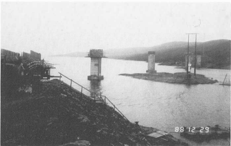
Her skal Ognasundet bru gå. Biledet er tatt ved årsskiftet, da fundamentet og søylene var på plass. Etter planen skal brua være ferdig den 23. desember i år.
