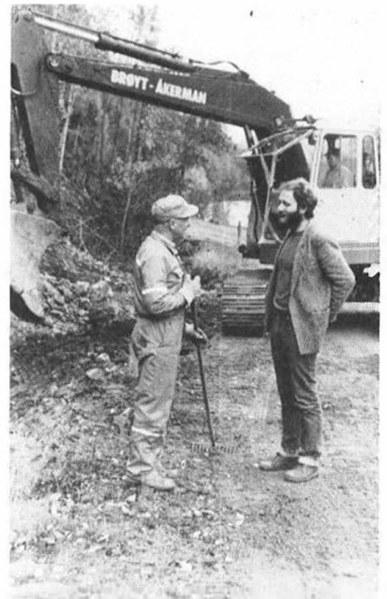
Etter utbetringa blir det også grøft langs vegen. Oppsynsmann Ove Frøylog (t.h.) drøftar arbeidet med Olav Kjelleberg.
