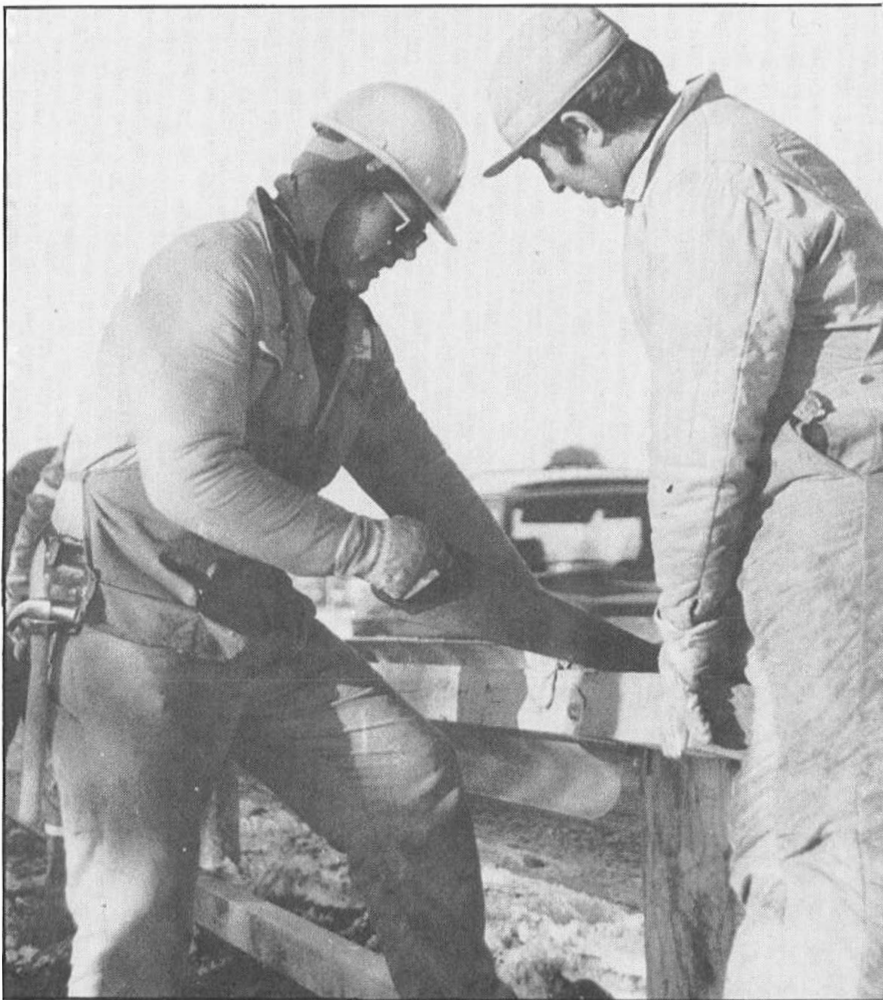
I vinter har arbeiderne på Solatangen for en stor del vært opptatt med å sette opp støyskjermer, ikke bare mot boligområdet ved Ljosheim, men også langs E 18 i Stavanger. På dette bildet fra «snekkerarbeidet» ved Ljosheim ser vi fra venstre Ole Henrik Aadnøy og Magnus Danielsen.
