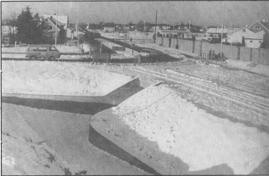
Solatangenten, strekning A-B (se kart). I det «fjerne» Solakrossen. I forgrunnen krysset ved Ljosheim med undergang. Når utbygginga er ferdig vil rv. 509/510 komme inn fra venstre i et T-kryss.
