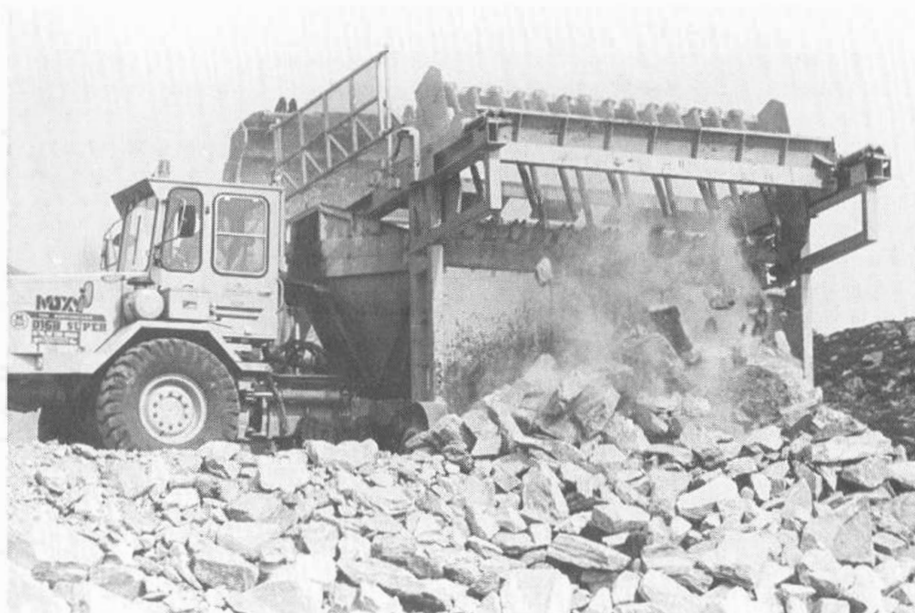
«Simbagrid» sorteringsverket i arbeid. Hjullastaren (skjult) har lyfta masse opp på grinda. Småsteinane har felle gjennom og ned i dumperen og dei store steinane blir tømt til sides.
