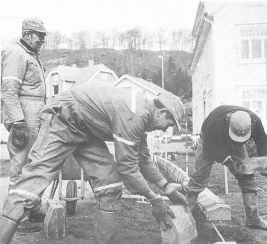
Frå arbeidet med «Strategi C». Normann Hellenen (t.h. med ansikt skjult) og Bernt Mong i arbeid med å leggja kantstein langs eit av fortava. Ingeman Leidland (t.v.) har akkurat kjørt til rettes ei hjulbår med sement.
