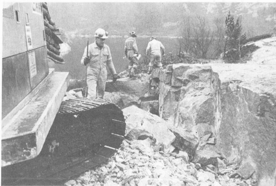
Ådne Meling gjør klar til sprenging. I bakgrunnen arbeider Yngve Damsgård og Toralf Jøssang. Foto: Ole Handland
