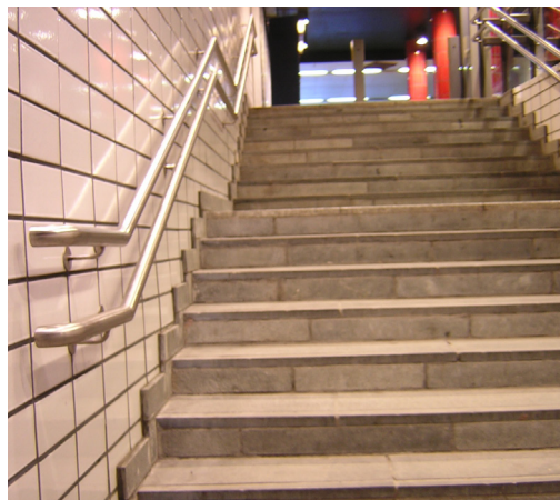
Oslo S. Riktig utformet håndlist i to høyder som begynner før trinnene. Foto: Elin Katrine Nilsen.
