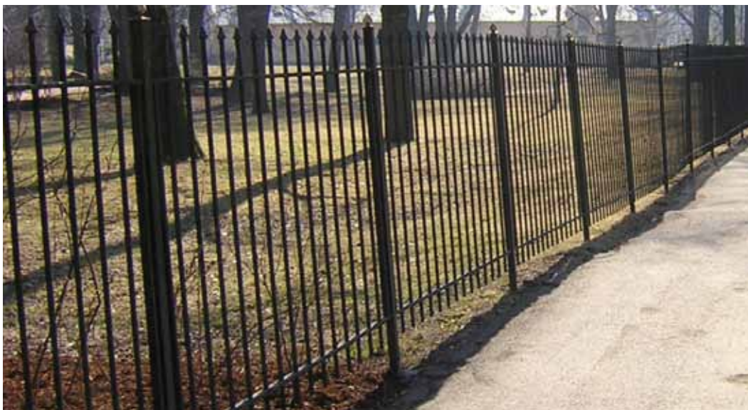
Slottsparken, Oslo. Gjerdet fungerer godt som ledende element fordi det ligger tett inntil gangveien og dermed kan følges med hånden eller stokken. Foto: Elin Katrine Nilsen.
