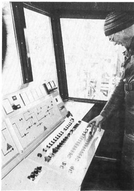
Vegsjefen starter prøvekjøringen av anlegget. Foto: J. Lund
