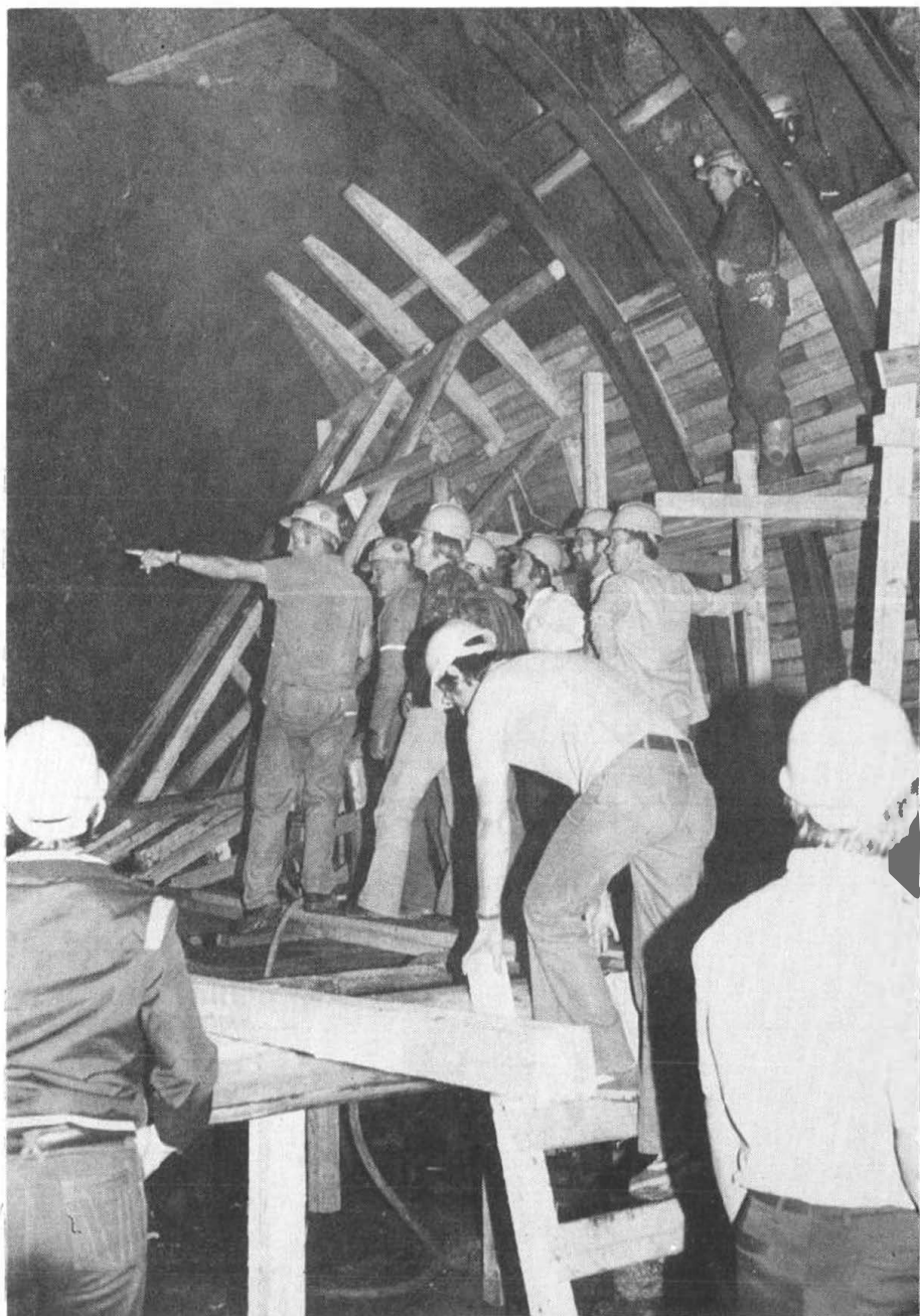
Anleggsavdelingens folk var på befaring i nord fylket i sommer. Fra tunnelarbeidene i Suldalsporten.
