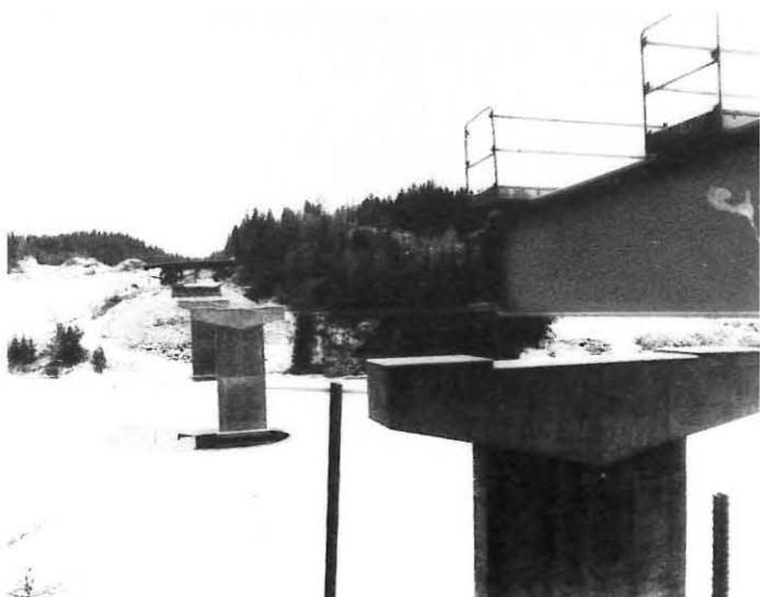
Brukarene står klar til å ta i mot de lange stålbelegene som monteres på østsiden av vassdraget. Bildet er sett fra øst mot vest.
