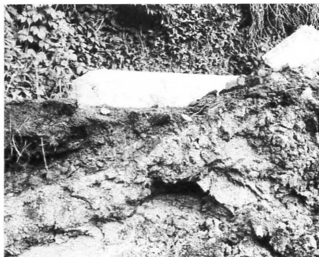
Graving i overbygningmassen på eldre veger viser at kvaliteten ikke alltid tilfredsstillende, og at utskiftning er påkrevd.
