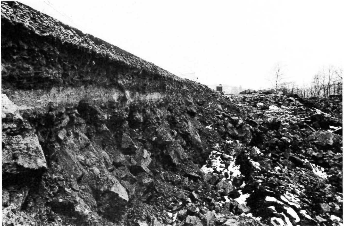
Under oppfylling for gang- og sykkelveg langs E-18 ved Tufta i Moland forsvant plutselig hele fyllingen ut i Longumvann på en 11-12 meters strekning. E-18 (til venstre på bildet) ble imidlertid stående igjen.
