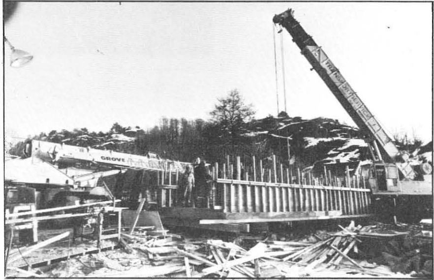
Brua ble delvis støpt ferdig på land, og senere sjøsatt ved hjelp av løftekraner
