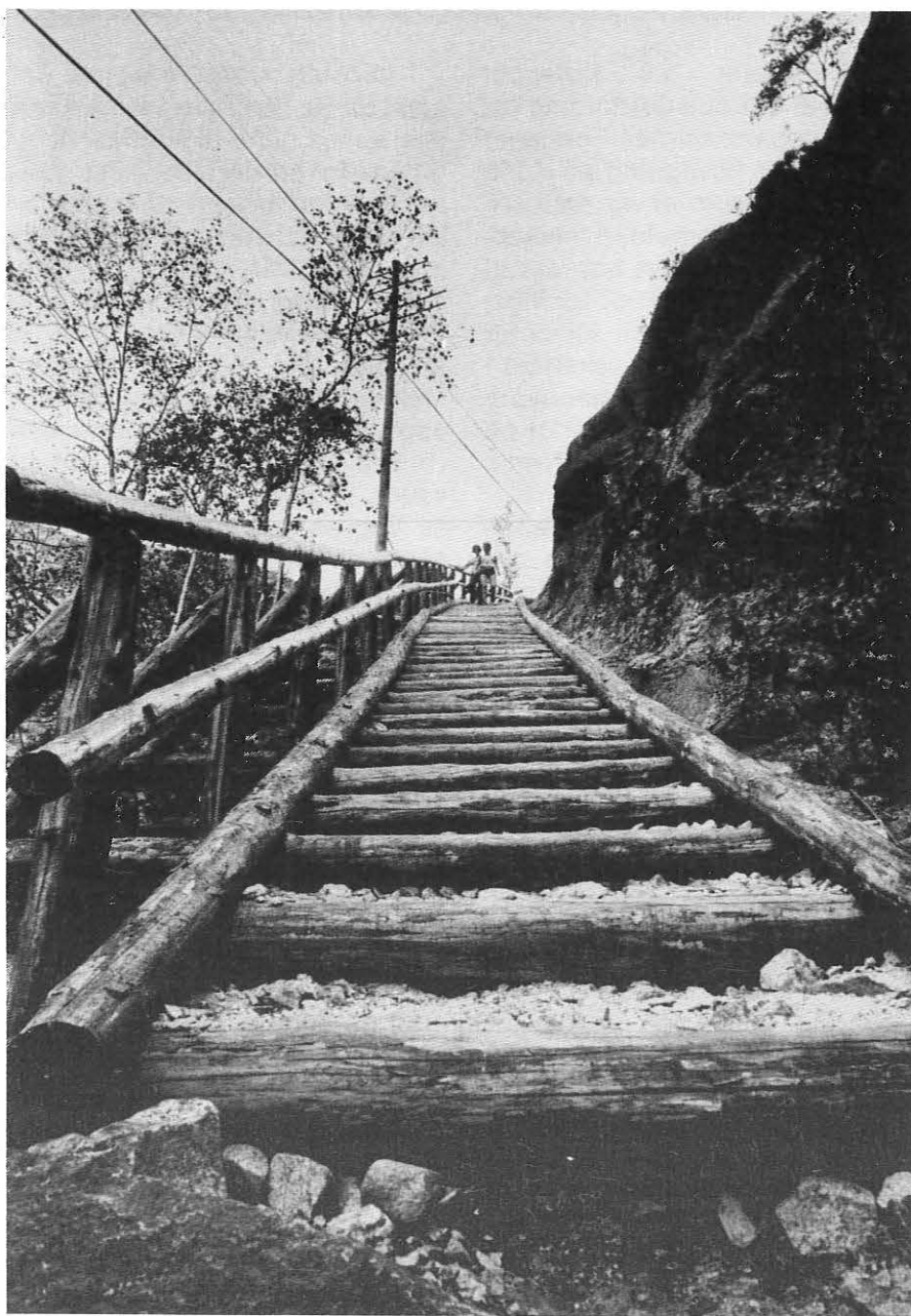
Den lange trappen ved Byklestigen får ikke plass på museet, men tar seg vel best ut der den ligger, i restaurert tilstand.
