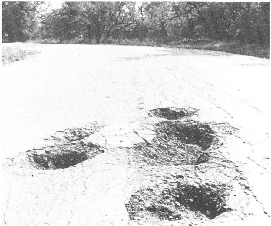
Dekkeskader som dette ser vi ofte, og kan lett repareres ved hjelp av Porta Patcher-masser.
