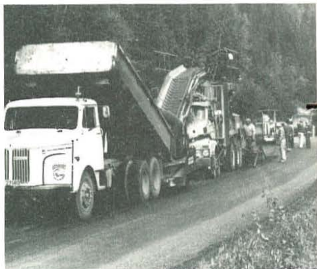
Fra grusen blir tippet og til ferdig lagt dekke, skjer alt i en eneste operasjon.
