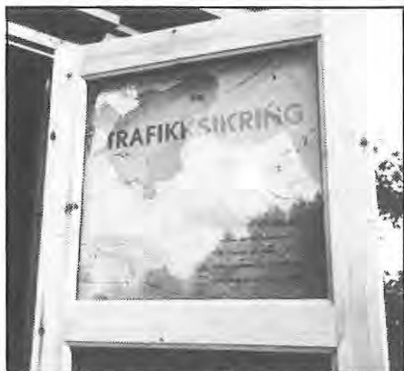
Knust vindu i døra. Kan dette hærverket være «Trafikksikring»?
