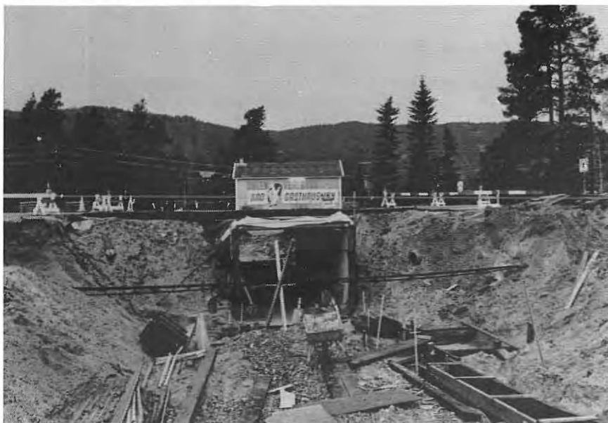
Undergangen på plass, trafikken satt på — og klar for etterarbeidene med murkanter og trapper.
