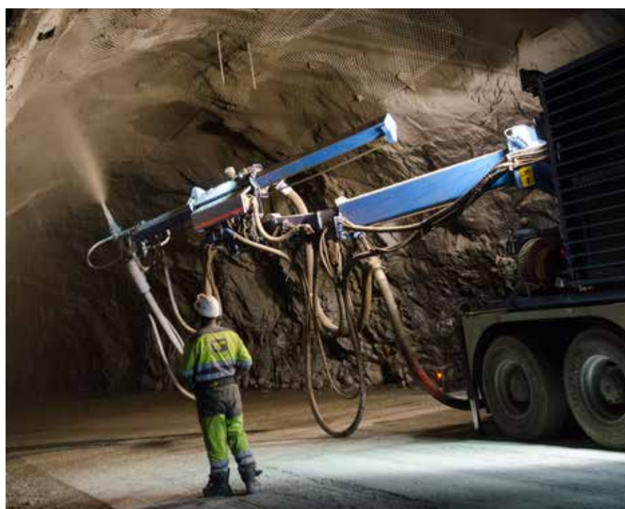
TRENGER OGSÅ OPPGRADERING: Gudvangatunnelen ble reparert etter trailerbrannen i 2013, men skal nå gjennom en betydelig sikkerhetsoppgradering. (Foto: Ole Kristian Åset)
