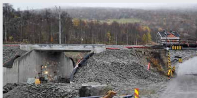
ULYKKE: Jernbaneundergangen på rv. 7 rett øst for Geilo, der sprengningsulykken krevde tre menneskeliv 3. september i år.
