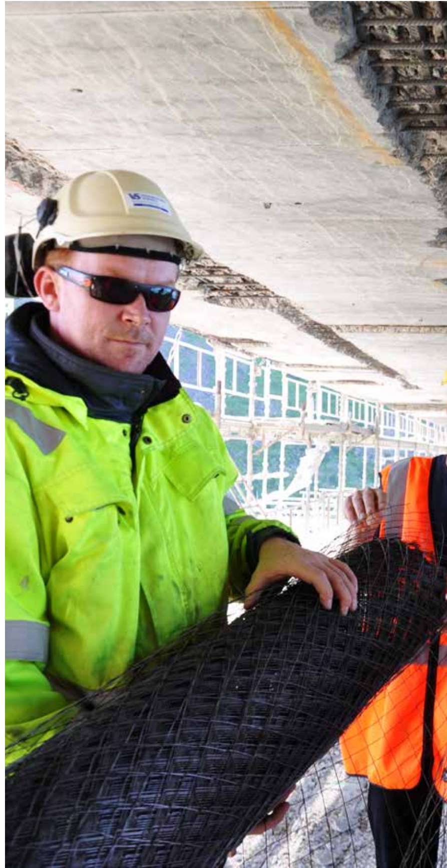
UTSATT FOR KORROSJON: Dette titannettet skal stanse korrosjon under den 37 år gamle Sundklakk bru. Bildet er tatt av Consolvo AS, og Vegvesenets byggeleder Linda Hansen.
