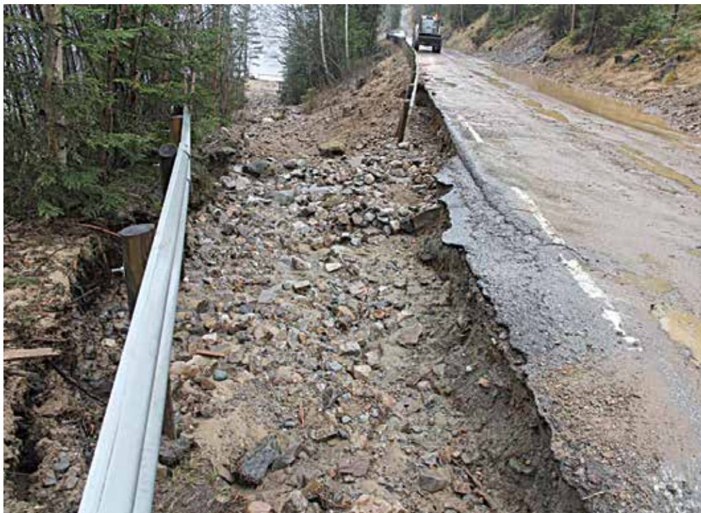
TELEMARK: Fv. 354 i Tinn kommune ble ødelagt av flommen. (Foto: Tor Arvid Austråt Gundersen)
