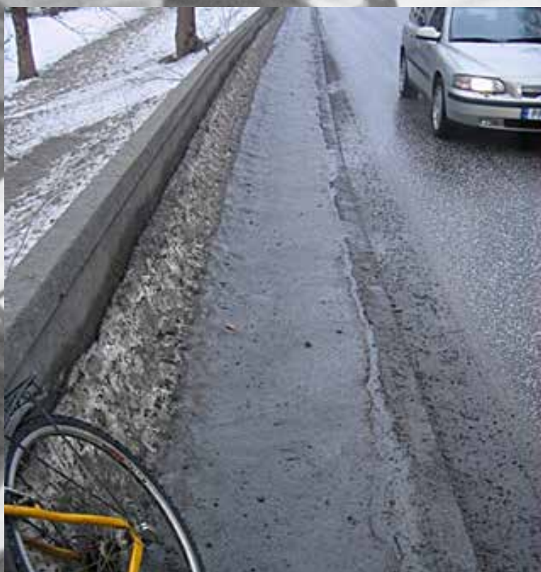
FORTAU: Fortau på senvinteren. Sentral gate med stor trafikk. Ytterligere kommentarer overflødig. (Ansvar: Statens vegvesen)
