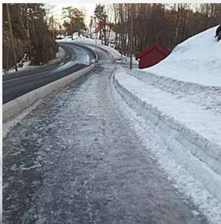
BRØYTING: Bratt bakke med blank, bulket is i kurve. Flere klager til tross, nyåpnet, fylkeskommunal veg til flere 10-talls millioner har vært nær uframkommelig i hele vinter på grunn av snø og is. (Ansvaret: kommune)
