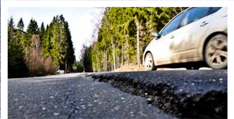
DYPE SPREKKER: Det koster mye å reparere vegene, men enda mer om sprekkene ikke blir reparert.
