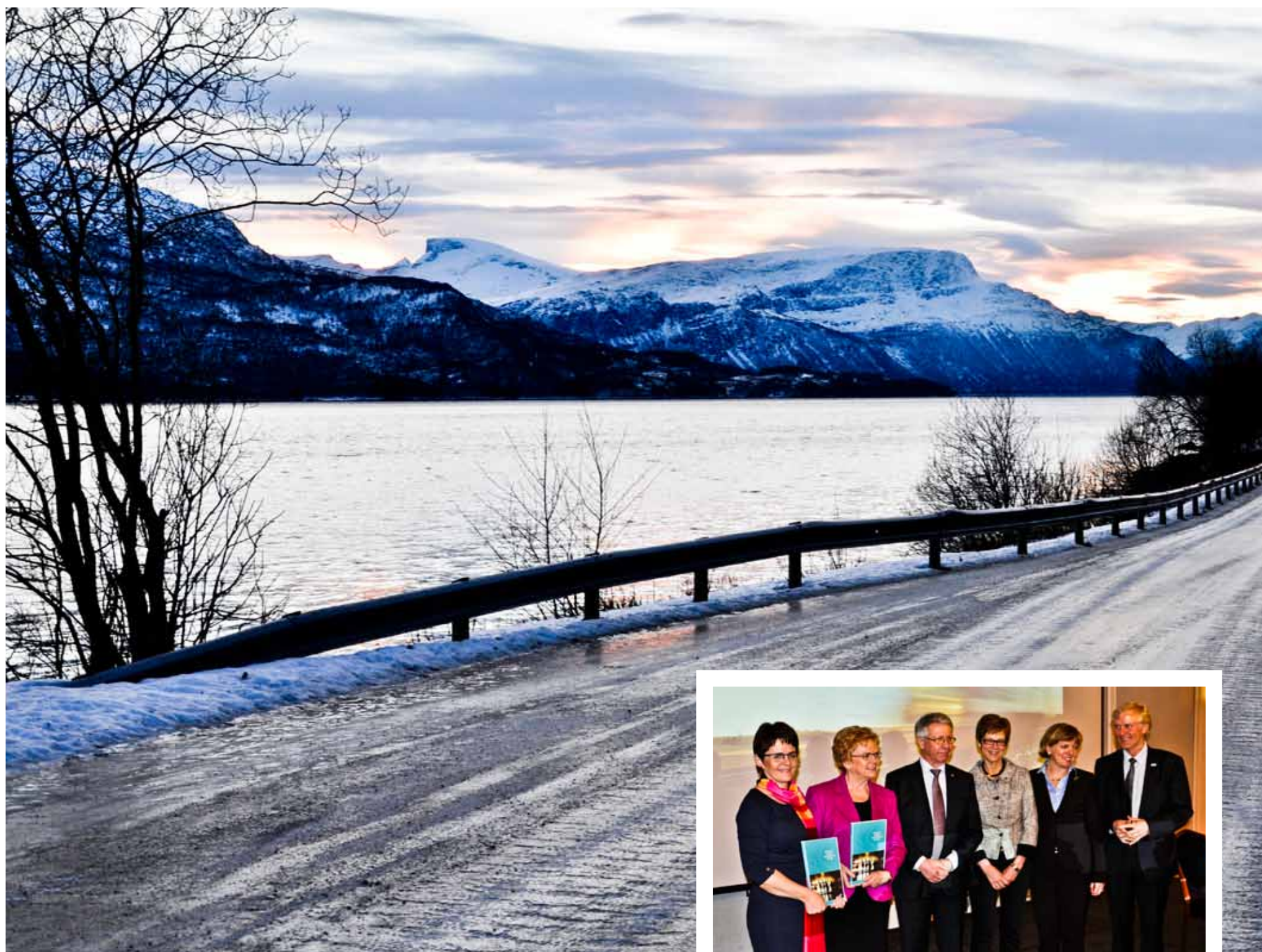
LYS I HORISONTEN: Med dagens bevilgningsnivå kan forfallet tas igjen på 20 år, med økte rammer på 15 år. Bildet er fra fv. 848 i Troms.
