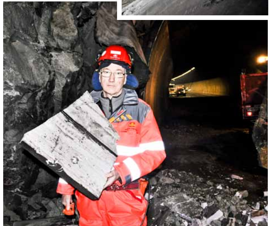
TOK IKKE FYR: Byggeleder Øyvind Holemark med isolasjon som smeltet men ikke tok fyr. Personbilen knuste betongelementet bak han. PE-skummattene (innfelt) ligger som vannbeskytter over hvelvingen og er dekket av 6-8 cm sprøytebetong. Et hjørne ble avdekket ved ulykken og flammene spiste seg 120 meter innover.
