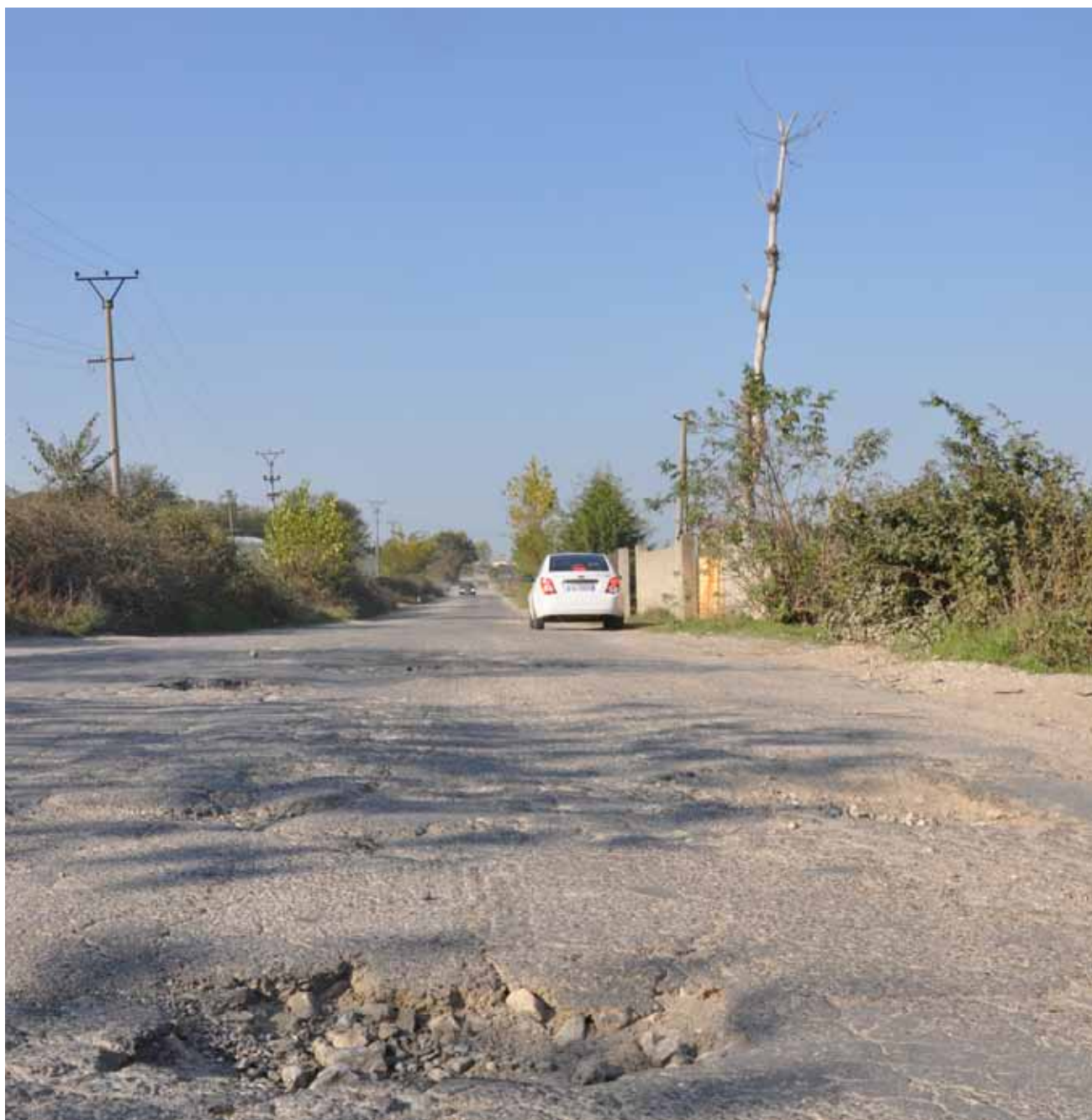
▲ FORTSATT RIKSVEG: Ti år etter at denne vegen ble avløst som hovedveg mellom de to største byene har den store hull som ikke repareres.
