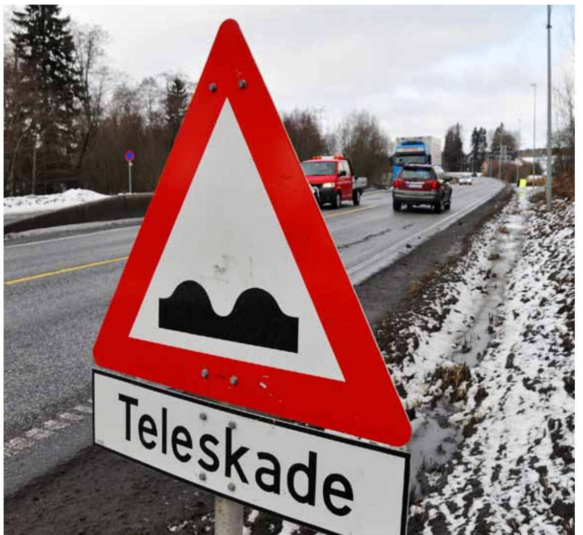
MANGLER Prosjekteringsfeil, mangler ved byggingen og underdimensjonert drenering blir pekt på som årsaker for telehiv på tre nye veger sist vinter.
