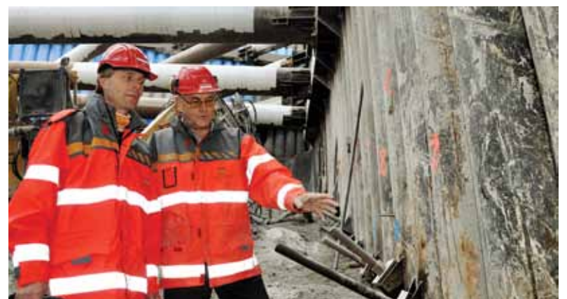
SPEIELL VEGG: Den 300 meter lange kvadratiske stålrørveggen er utviklet spesielt for Trondheimsprosjektet i samspill mellom Statens vegvesen, hovedentreprenøren NCC og underentreprenøren Kynningsrud AS. Metoden har fått stor oppmerksomhet i bransjen og er aktuell for et tilsvarende byggeprosjekt i Singapore.
