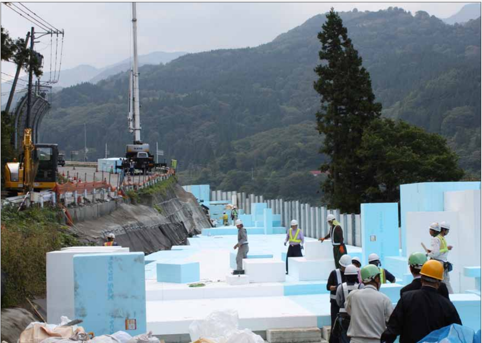
Puslespill: Fra befaring ved Otari, etablering av fylling. Sett fra oversiden. Plassering av EPS-blokker som et puslespill.
