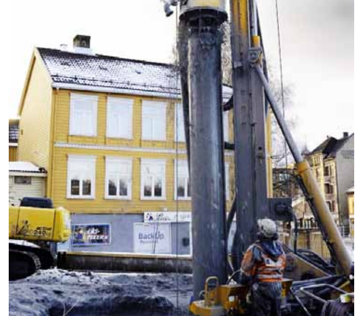
Spruter: Kvikkleiren spruter opp av stålroret på Møllenberg i Trondheim. (Foto: Torgeir Jensen)
