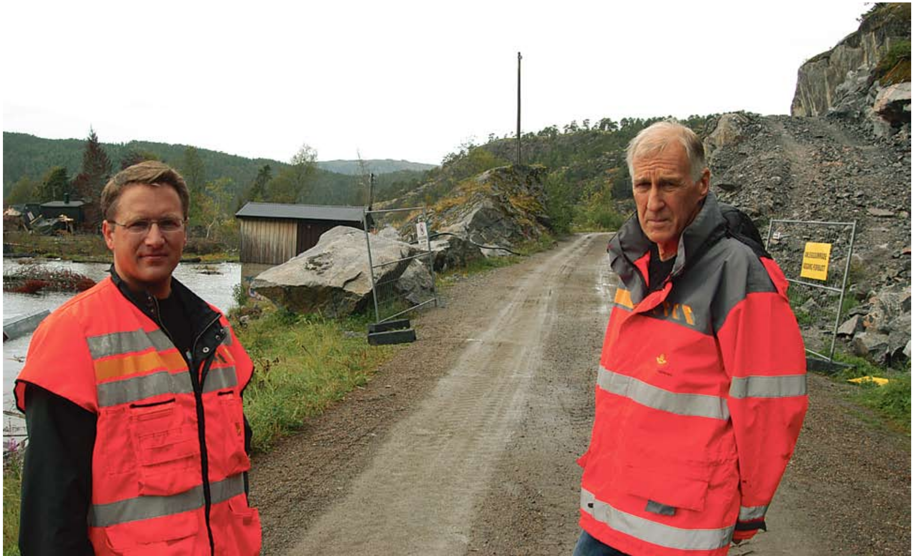
Rassted: Prosjektleder Kolbjørn Engen og byggeleder André M. Aglen ser fram til å fullføre Kattmarkavegen. Fjellskjæringen i bakgrunnen skulle dobles i bredde med midler fra Namdalsprosjektet da en dynamittsalve utløste et stort ras i mars. (Foto: Håkon Aurlien)
