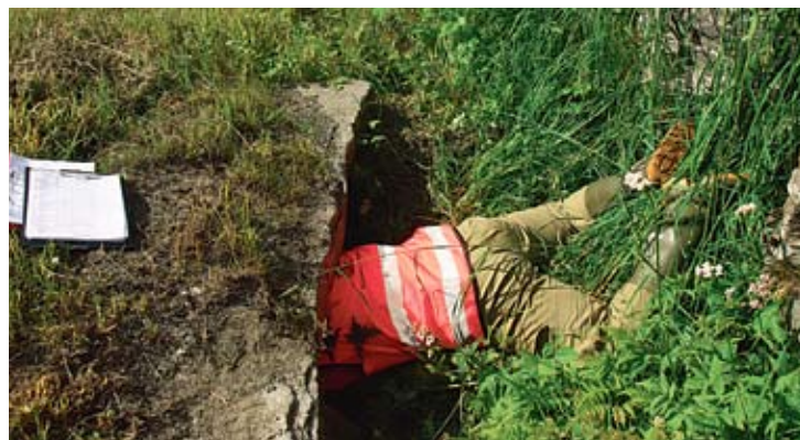
Grundig sjekk: Hilde Hesthagen i aksjon for å sjekke forholdene i en stikkrenne. Mer ekstremvær gjør at en må vite mer om kapasiteten og hvilke tiltak en bør utføre. (Foto: Kristine Flesjø)
