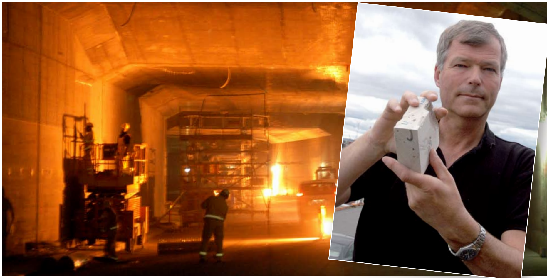
Unikt materiale: Prosjektleder Svein Røed (innfelt) har valgt et unikt sementbasert isolasjonsmateriale til brannsikring av Bjørvikatunnelen. (Foto: Håkon Aurlien)
