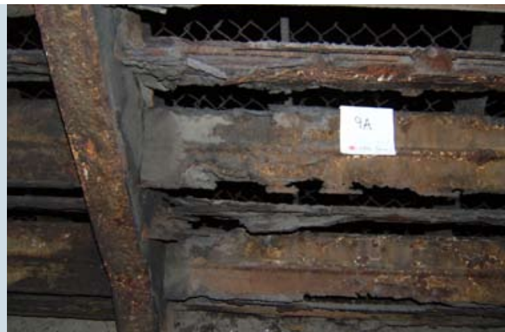
Ruster opp: Tilstanden til spjeldet på en av ventilasjonsviftene forteller om forfallet i tunnelen. (Arkivfoto: Mesta)
