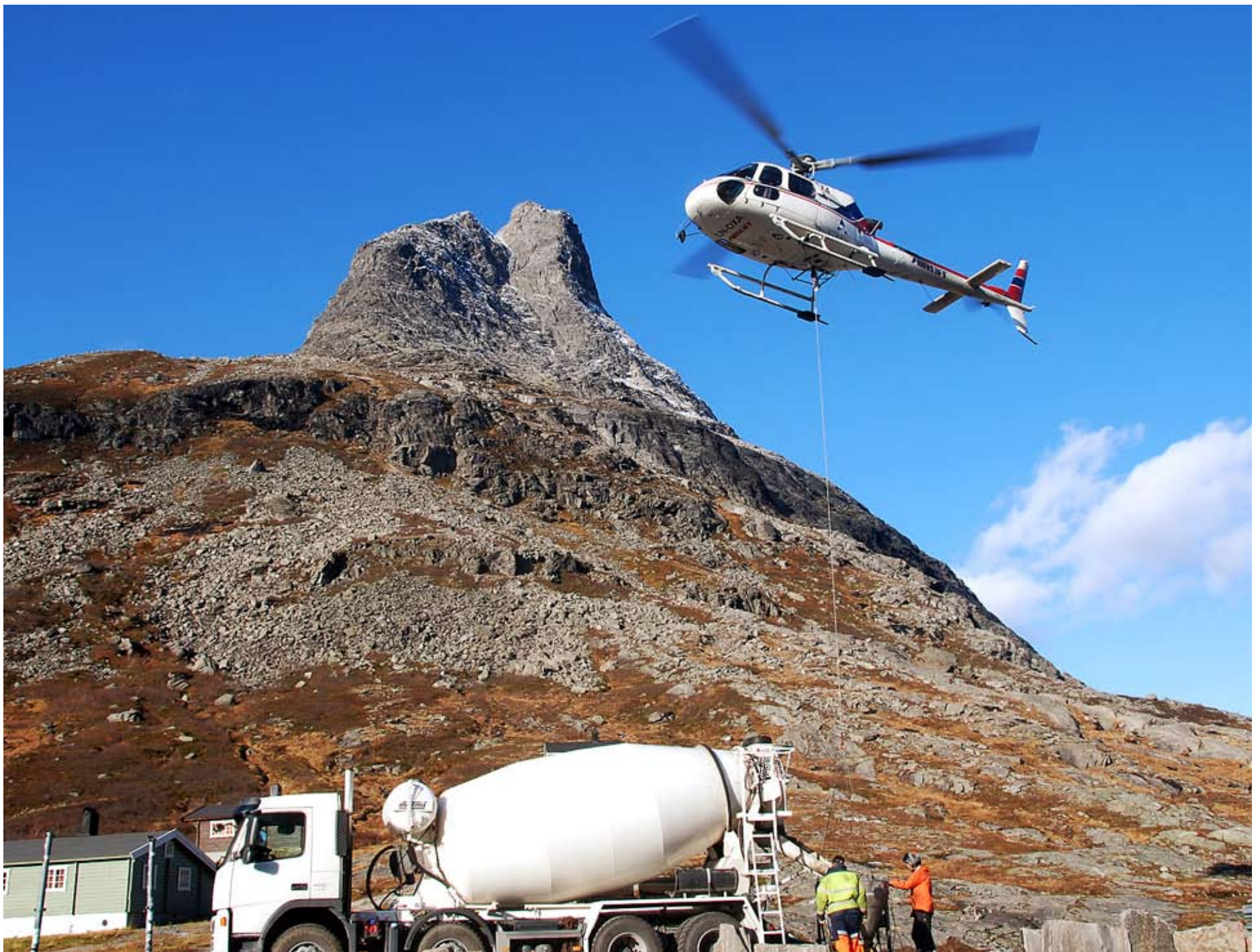
Luftig jobb: Heilkopter måtte frakte fram betong under arbeidet med nye utsiktspunkt i Trollstigen sist haust. (Foto: Magne Flemsæter)
