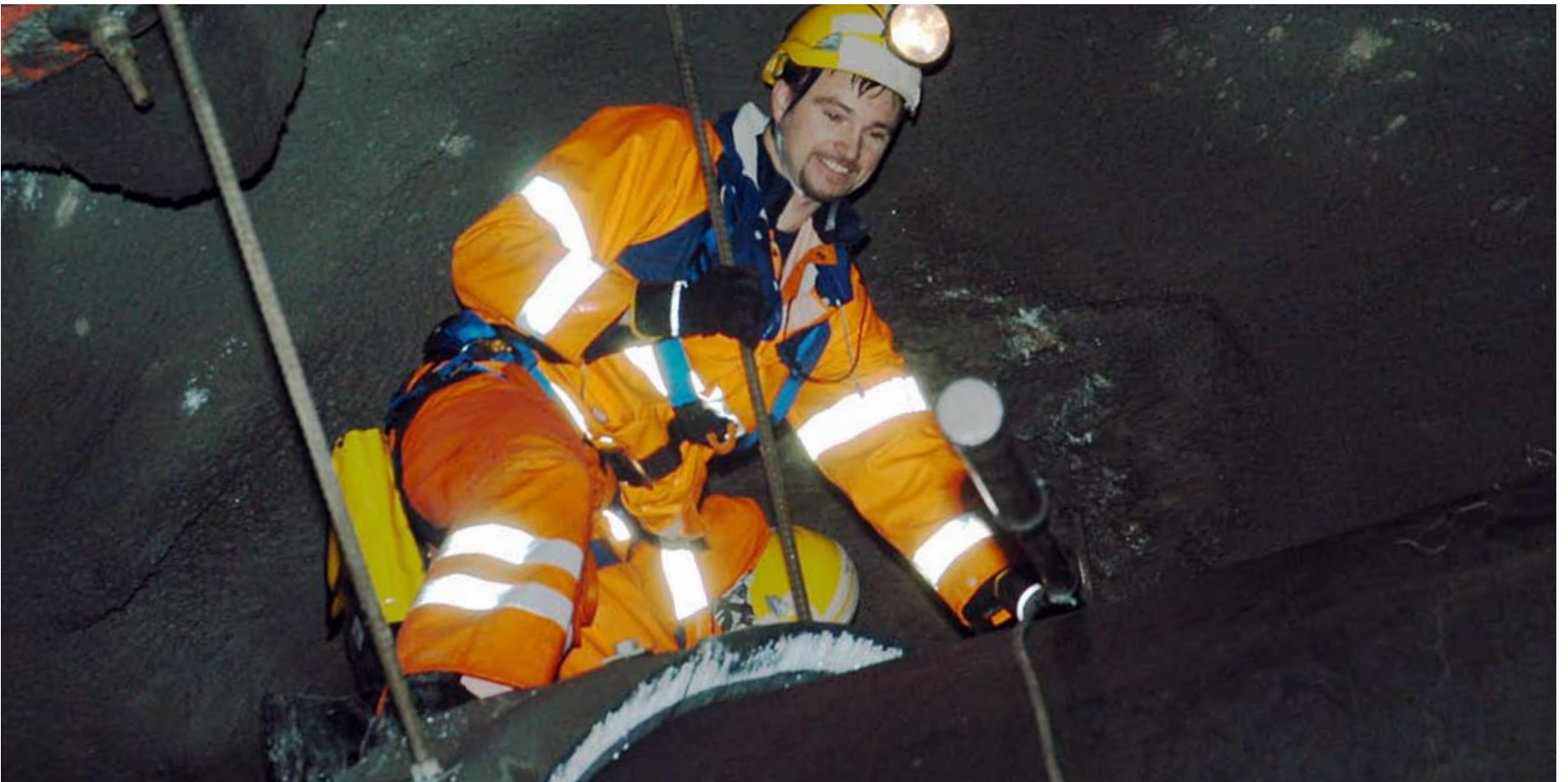
Trongt: Det er ikkje mykje plass til inspeksjon mellom fjellet og tunnelkvelvet i dag, men i framtidens tunnelar kan det bli meir plass til inspektørane. (Foto: Edvard Iversen)
