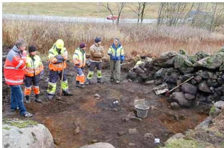
Ny E39: Nå graver arkeologer i bakkene mellom Fardal og Udland. I januar-februar tar anleggsmaskinene over. (Foto: Kjell Wold)
