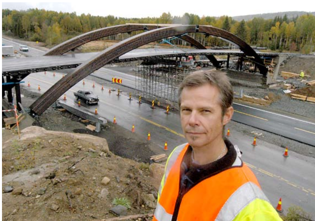
Kreativ: Trond Arne Stensby finner stadig nye løsninger for trebruer. Her er han foran Skogsrud trebru som ble satt opp ved Tangen i Hedmark i høst. Brua er den første av en helt ny type trebruer, har veldig liten konstruksjonshøyde og ruver dermed lite i terrenget. (Foto: Håkon Aurlien)
