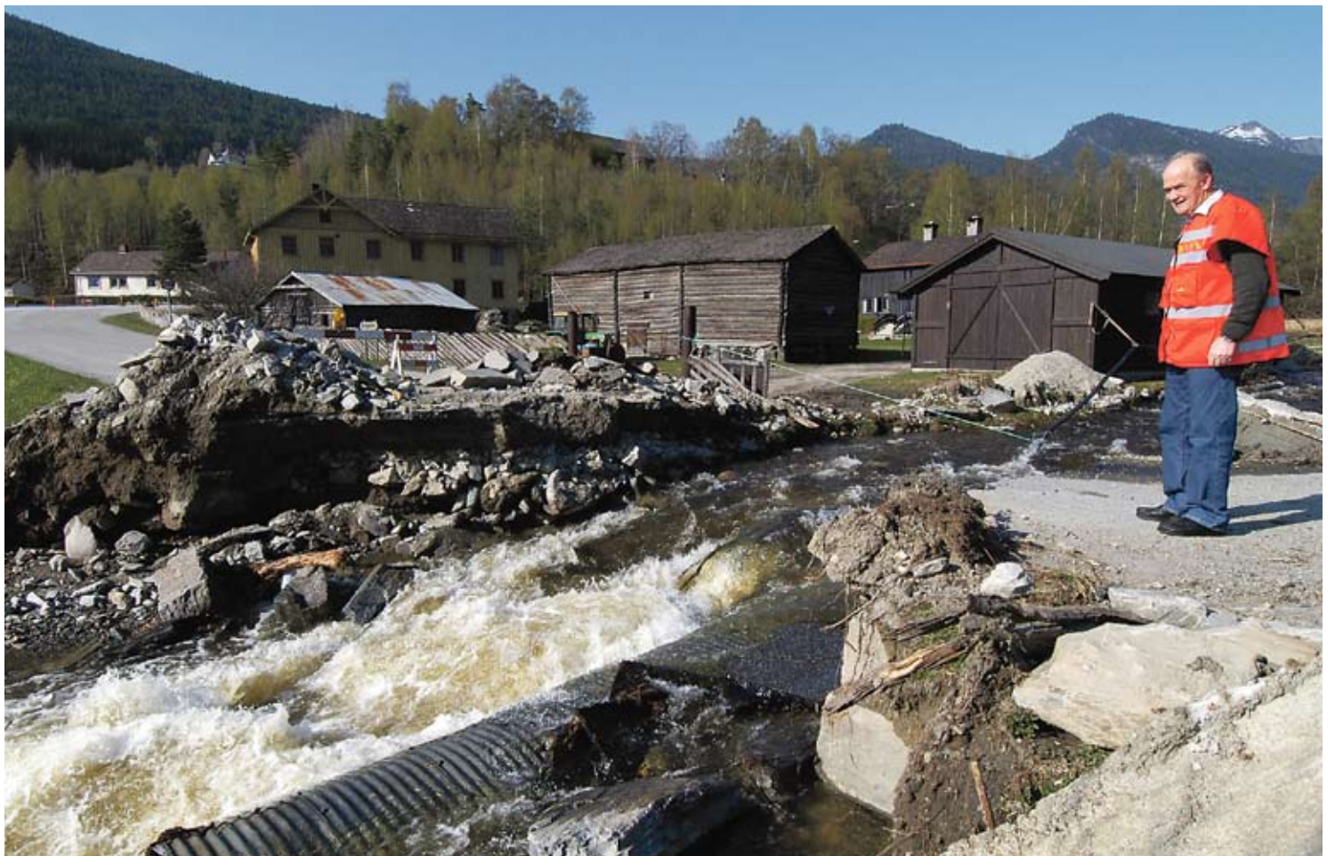
Overgravd: En kulvert under fylkesvegen gjennom Sel gikk tett og vegen måtte graves over for å unngå skader på hus og jernbane. (Foto: Håkon Aurlien)
