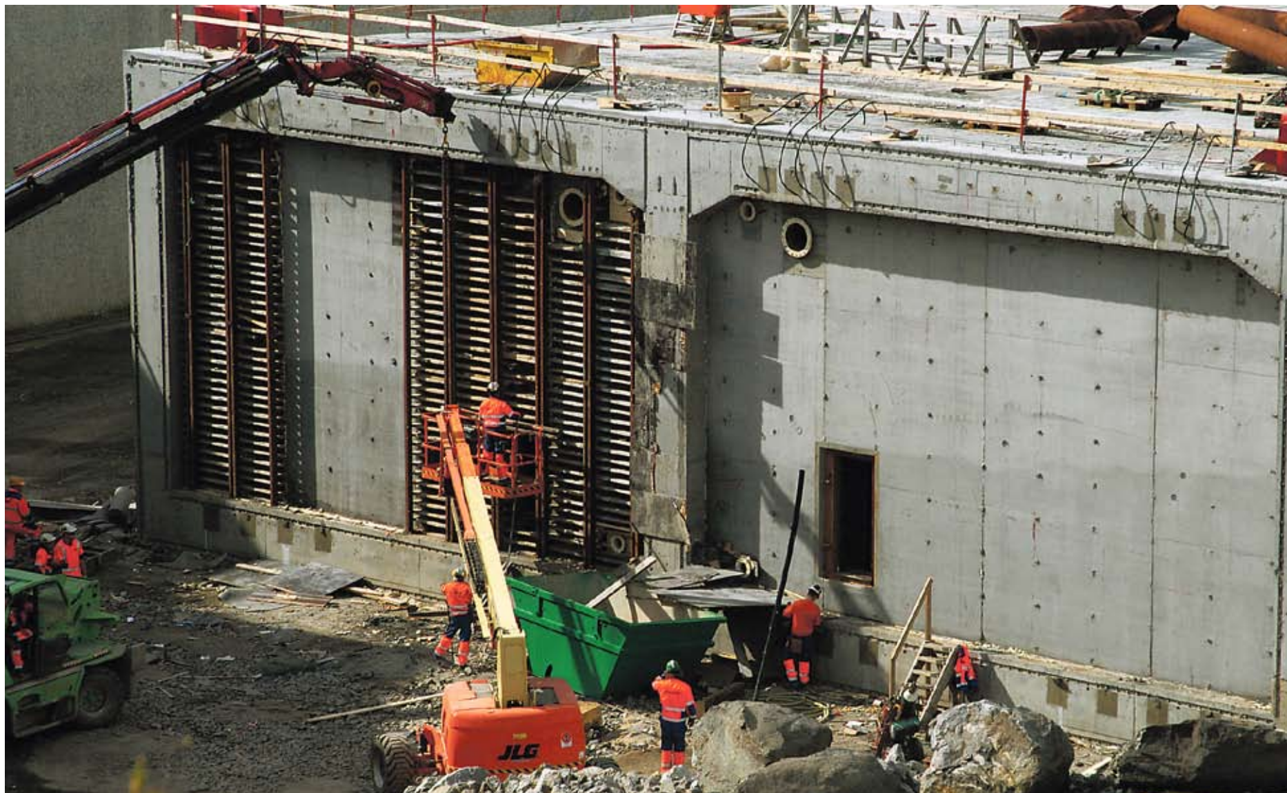
Gjør klar: Mannskapene er i gang med klargjøring til sjøsetting og slep av senkeelementene. [Foto: Geir Brekke]
