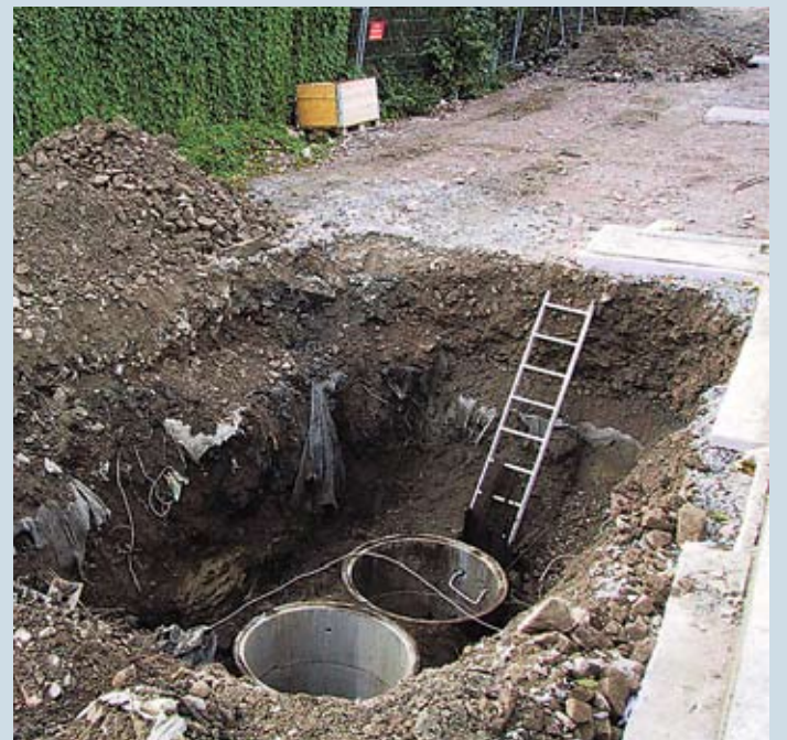
Dødsulykker på jobb: De fleste dødsulykker på jobb virker unødvendige. Her eksempel på usikret arbeidsplass. (Arkivfoto: Arbeidstilsynet)
