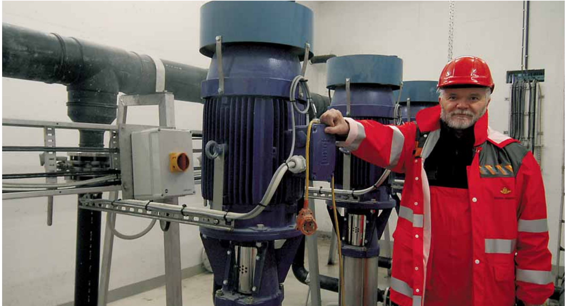
Pumperommet: Prosjektleder Bjarne Lysberg har pumpene klare på botnen av Halsnøytunnelen. (Foto: Geir Brekke)
