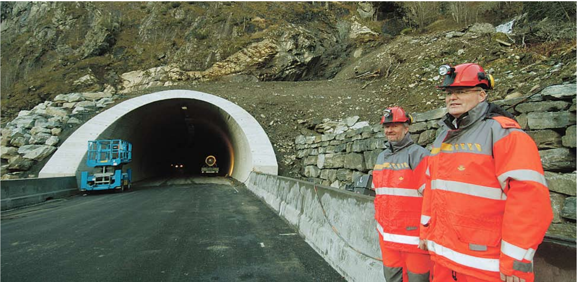
Holet på plass: Jostein Fjøsne (t.v.) og Helge Giljarhus i Statens vegvesen måtte flytta påhogget for den nye Myrkdalstunnelen. (Foto: Geir Brekke)
