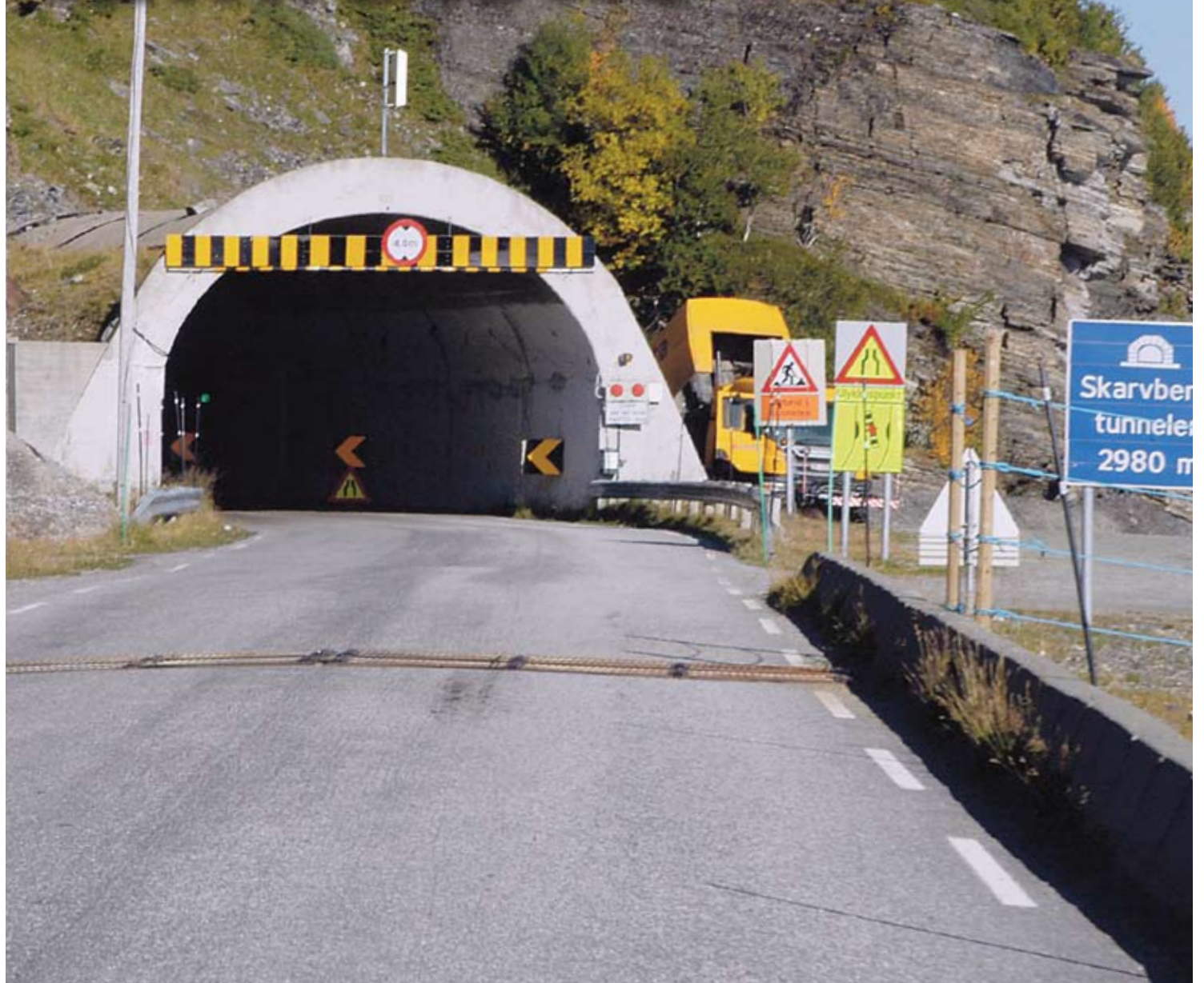
Dårlig sikret: Skarvbergtunnelen i Finnmark har også vært truet med stenging på grunn av dårlig brannsikkerhet. (Foto: Giselle Jensen)
