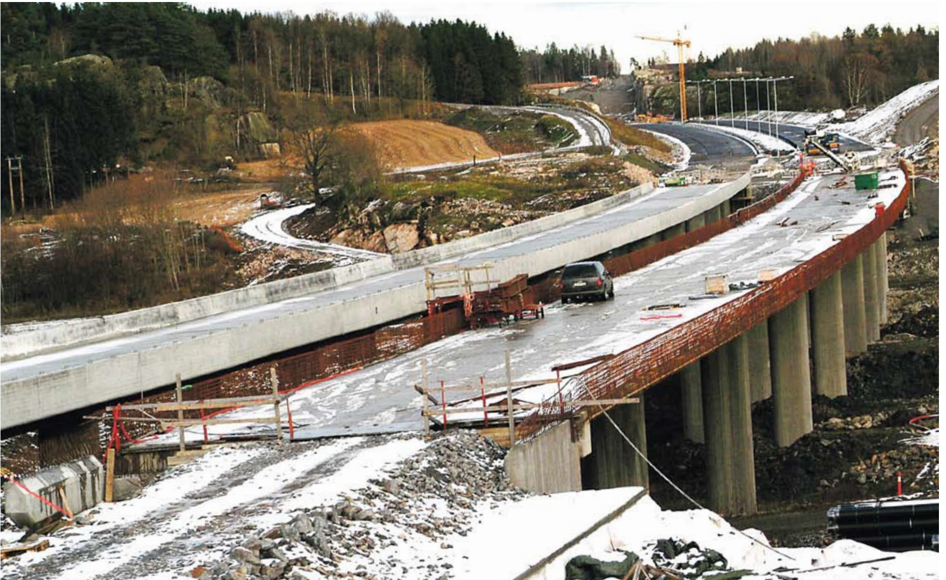
Veg under bygging i 2008: 8,2 kilometer ny firefelts E18 i Vestfold under bygging i år, åpner i juni 2009. (Foto: Kjell Wold)
