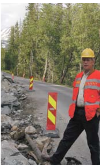
Fjellnøtt: Her er fjellet så løst at det er krevende å utvide og sikre vegen, sier Trond Solbakken i Statens vegvesen. (Foto: Kjell Wold)
