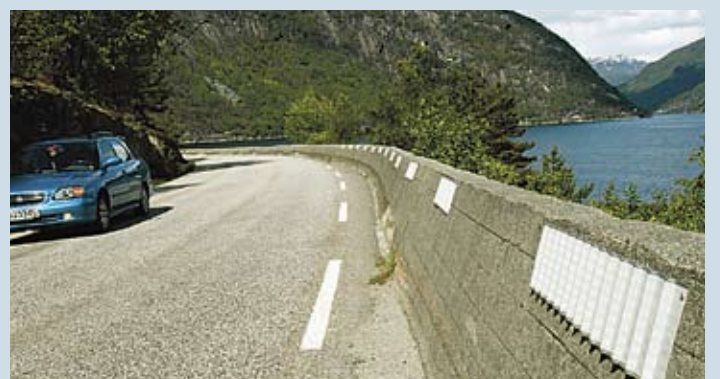
Refleksplater: Dei ruglete refleksplatene på støypekanten (t.h.) gir tungbilane sjansen til å varsle møtande trafikk med køyrelysa gjennom smale svingar. (Foto: Geir Brekke)
