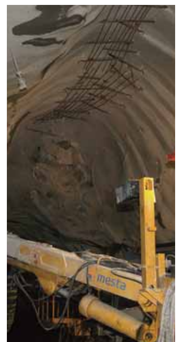
Plombert: Rasområdet i E18 Hanekleivtunnelen er nå tettet og plombert. (Foto: Kjell Wold)
