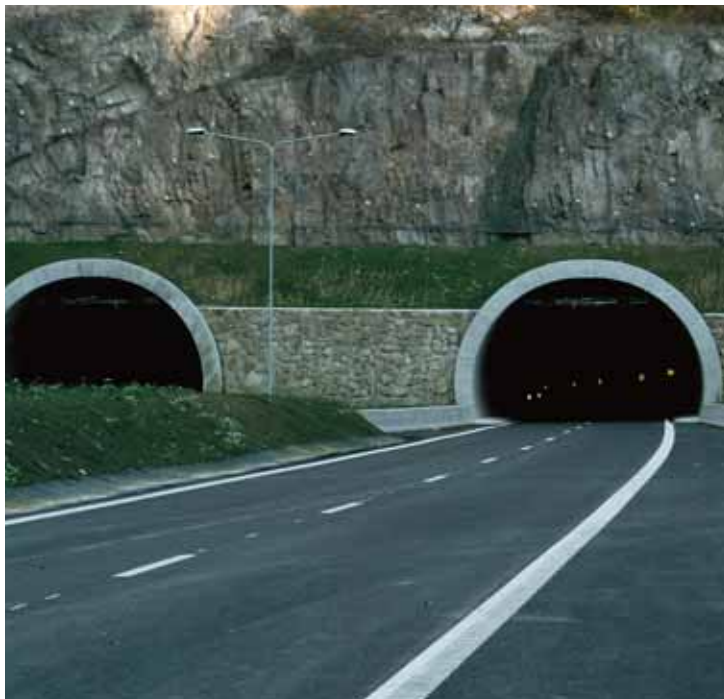
Flårtunnelen: En av tre tunneler på ny E18 i Vestfold som må gjennom omfattende sikkerhetssjekk før åpning. (Foto: Kjell Wold)
