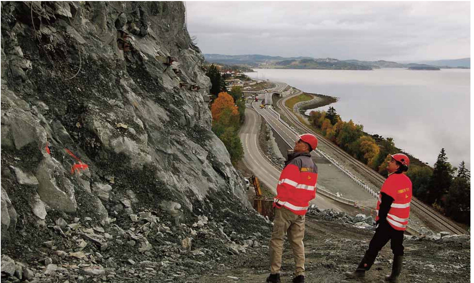
Langt ned: Opptil 40 meter over E6 arbeides det for å utvide europavegen til fire felt. (Foto: Christin Hermann)
