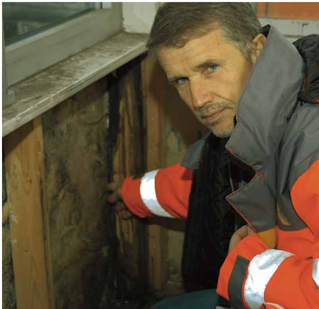
Fukt: - Vi renoverer alle Oslos bomstasjoner på grunn av fuktskader. Vi håper å få klarsignal fra Datatilsynet til å sette opp automatiske stasjoner i Oslo fra 1. februar, sier Geir Kjøningisen. (Foto: Henriette Erken Busterud)
