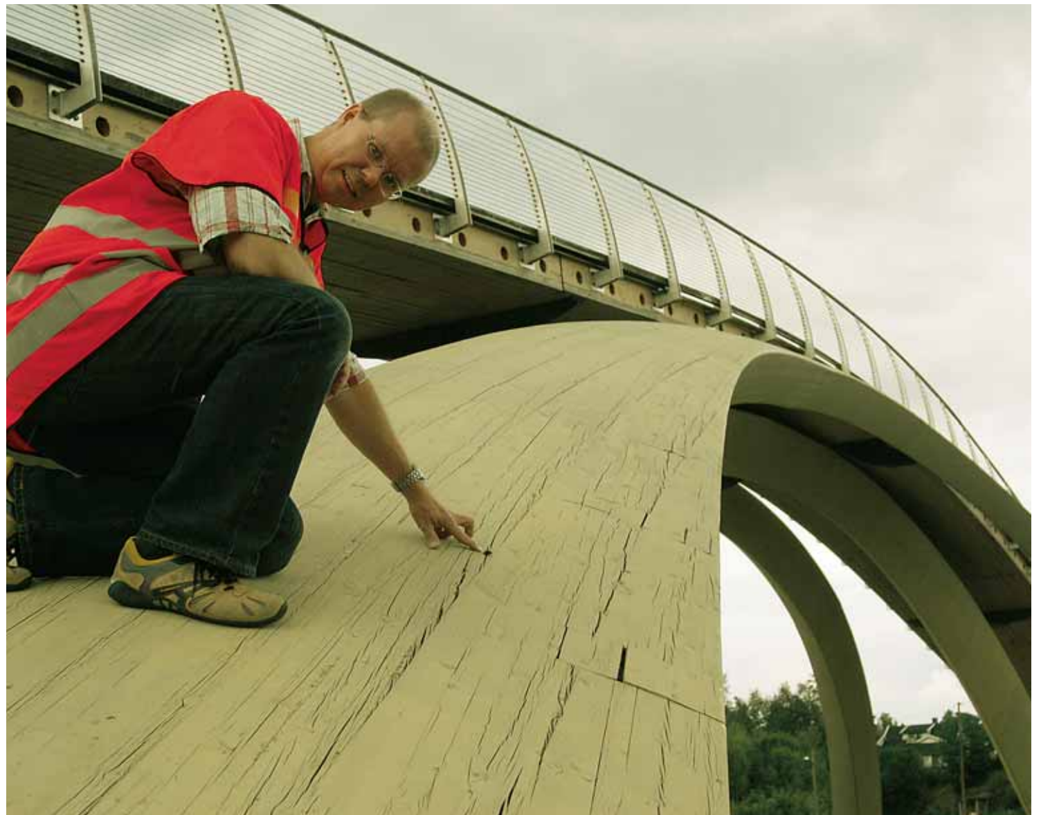
Må sikre brua: Limtreflatene mot syd er sprukket opp og i disse vokser vedmuslingen. - Nå må flatene beslås, sier vedlikeholdsbyggeleder Morten Wright Hansen. (Foto: Håkon Aurlien)
